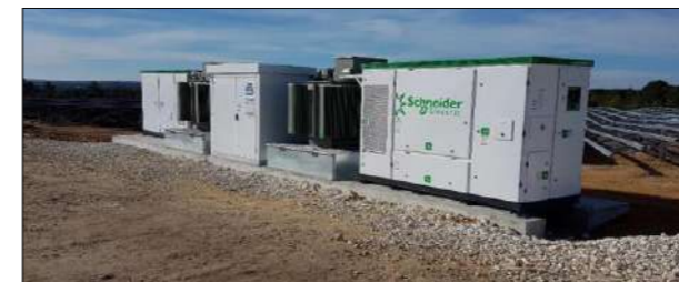
Exemple de bâtiments techniques « outdoor » (source : NEOEN)
